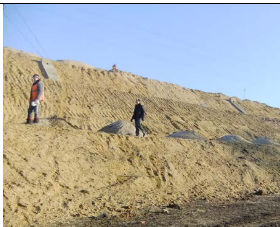
Фотография насыпи усиленной контрбанкетом
